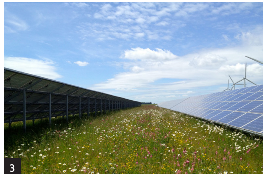
Kruidenrijk grasland onder zonnepanelen.
