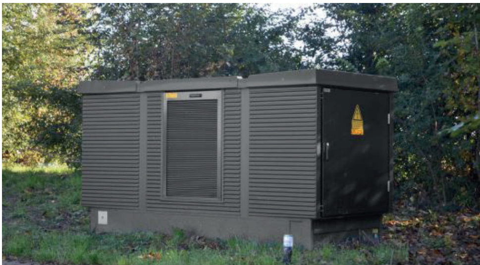
Voorbeeld van transformatoren (kleur: flessengroen).
